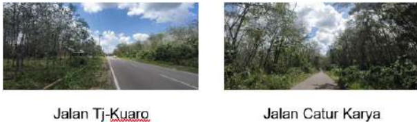
Gambar 6. Kondisi Fisik Jalan Sumber: Dokumentasi Penulis, 2023
